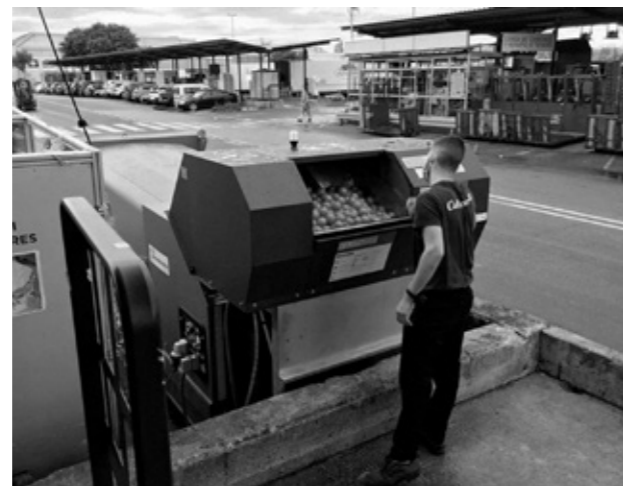
Los nuevos compactadores de materia orgánica del Mercado Central de Frutas y Hortalizas.
